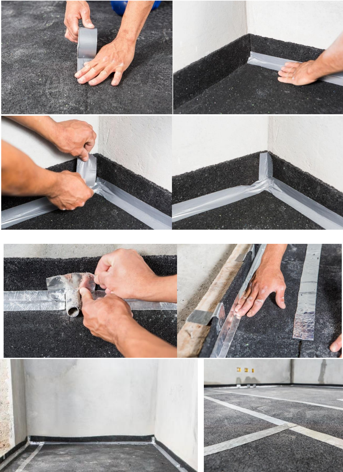
Imagens 21, 22, 23, 24, 25 e 29 Fotos ilustrativas do passo a passo da instalação da "Fita tipo Silver Tape" na Manta e Rodapé
